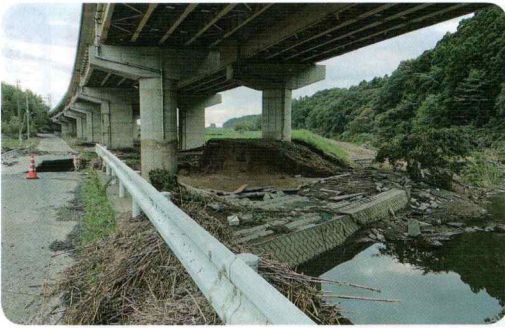
常磐道下の田野川堤防決壊
