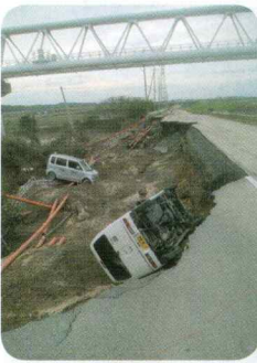
道路陥没で転落した車
